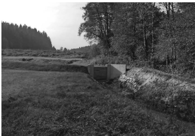
Überlauf des Absetzbeckens mit Ablauf zum Reichenbach
